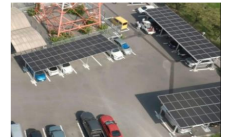
八洲建設本社駐車場ソーラーカーポート
