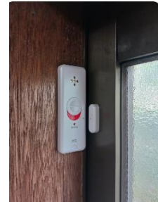
(防犯ブザー設置)
